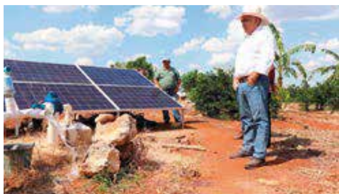
Bombeo Solar Sumergible Cooperacion Española AECI - Sullana
